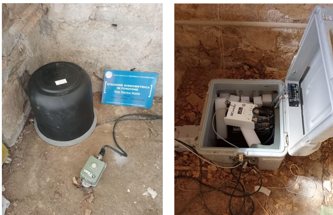
Figura 2.3. Nuova strumentazione alla stazione MALA0 installata in data 15 aprile 2024.
